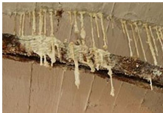
Obr. 5 Výluh (krápníky) na podhledu
