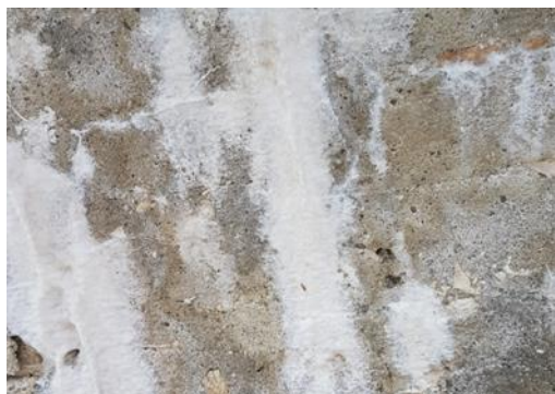
Obr. 4 Výluh na povrchu betonu
